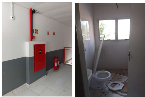
FOTO 06 - HIDRANTE E SANITÁRIO
