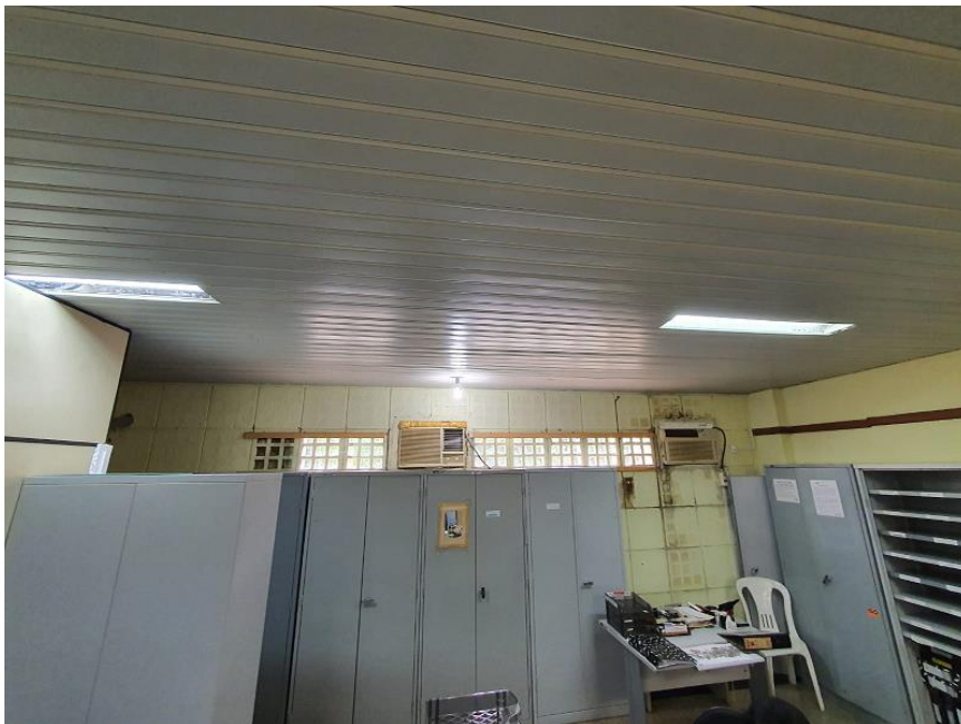
Figura 03: Vista da sala central de mandados. Parede ao fundo que deverá ser refeita.
