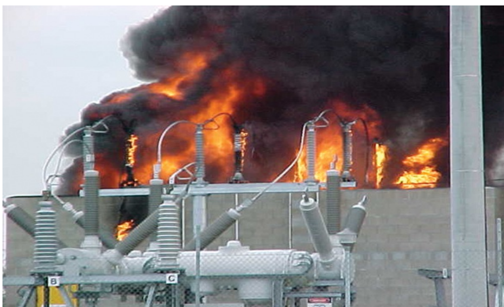
Foto do incêndio na subestação do Amapá em 12/2020.
